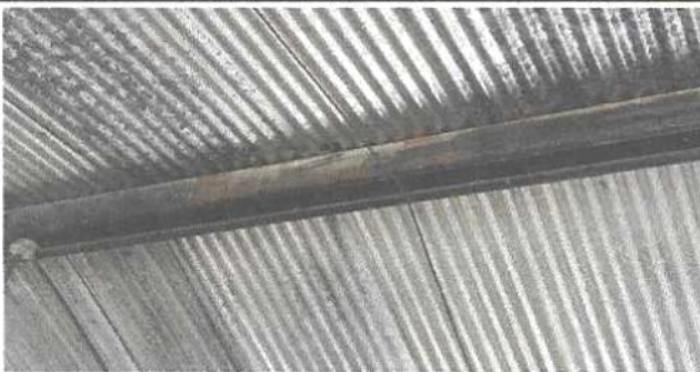
Foto 3: en el interior del módulo se observa empieza a sufrir deterioro la estructura de fijación.
