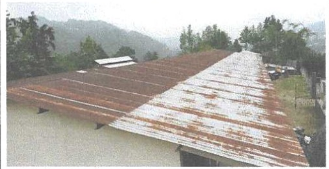
Foto 2: la parte de enfrente se observa el más afectado por el óxido ya que está a punto de perforarse.
