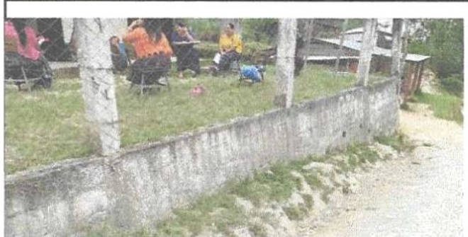
Foto 4: se observa que el muro de contención ya se encuentra deteriorado.
