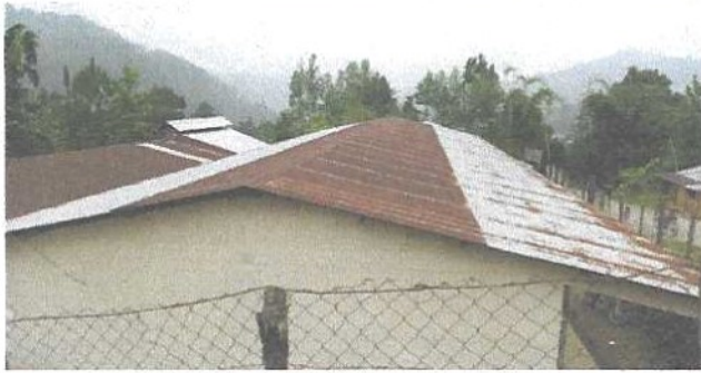
Foto 1: se observa que los dos lados están deteriorados en la estructura del techo de la escuela.
